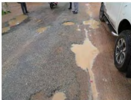
地方道の欠損
