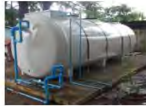
近畿地方166件 (例:滋賀県の浄化槽)
