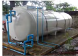
近畿地方173件 (例：滋賀県の浄化槽)
